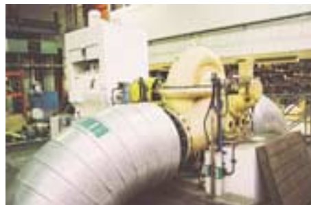
På Igelstaverket finns fyra pumpar för varmvattnet i fjärrvärmenätet. Var och en har en kapacitet på 2 800 m 3 per timme.
